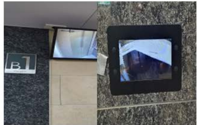
(안심승강기용 CCTV시스템 적용)
