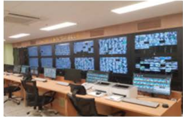
(CCTV 모니터링 공간배치 양호)
